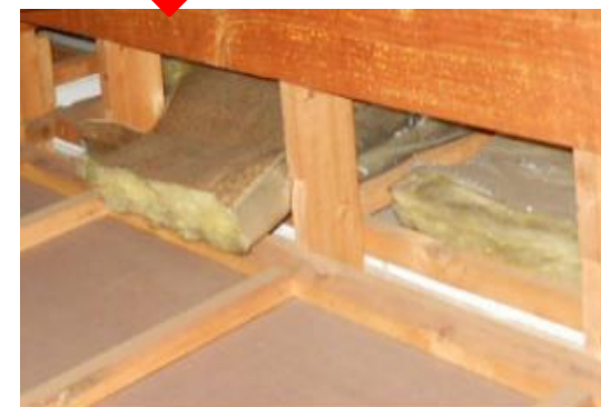
断熱材がない
