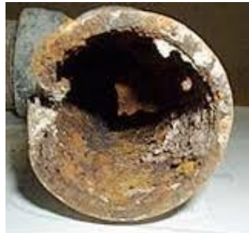
亜鉛メッキ鋼管の腐食例
