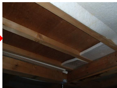
断熱材がない
