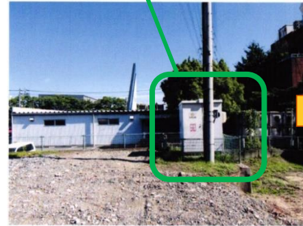
キュービクルの小窓から 稼働しているかどうか確認
